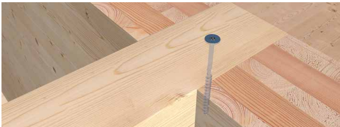
Mittels der SawTec Teilgewindeschraube wird ein Unterzug an der ausgeklinkten CLT-Wand befestigt.
