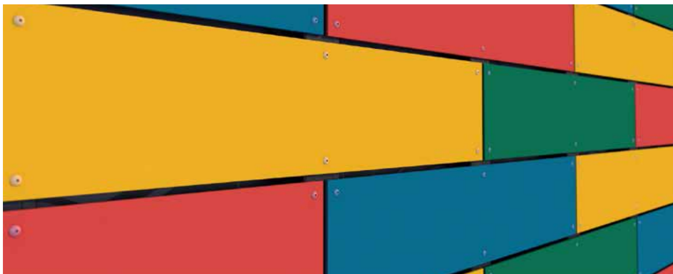
Płyty warstwowe (HPL) mocowane przez dopasowane kolorem wkręty elewacyjne .
