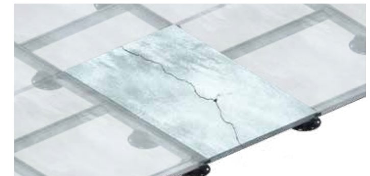
Erhöhte Bruchgefahr einzelner Platten aufgrund fehlender Stützprofile.
